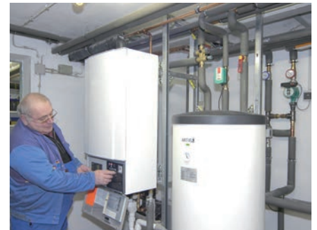
Trinkwasser-Installationen in Ein- und Zweifamilienhäusern gelten immer als Kleinanlagen, die nicht untersuchungspflichtig sind.
